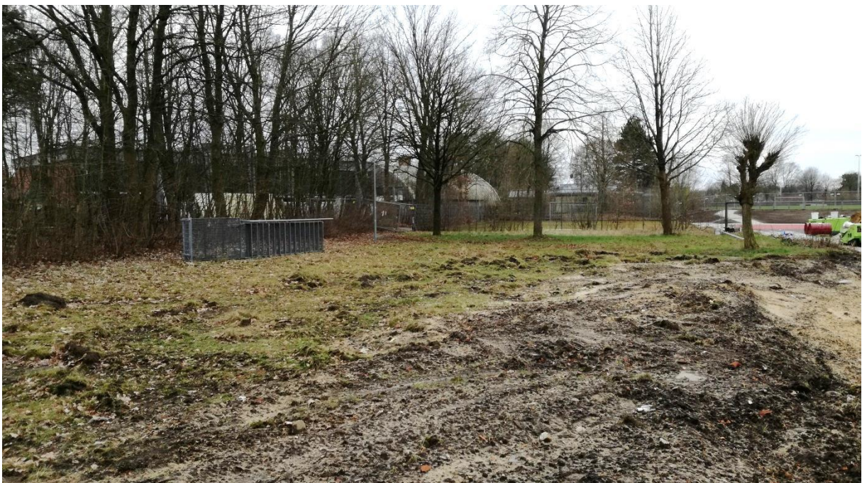
Abb. 10: Grünanlage des ehemaligen Sportplatzes und Baustelle, 4 Einzelbäume an der Grenze zum verbleibenden Sportplatz, die nicht erhalten werden
